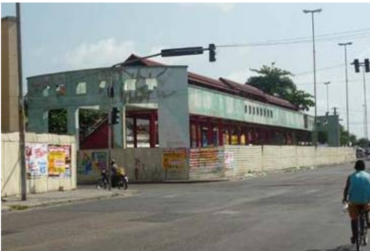
Figura 6. Módulo 6, Calçadão dos Mascates , em estado de abandono. Foto Nóbrega 2010
